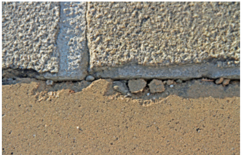
Abbildung 12: Kantenschäden an den zur gebundenen Pflasterdecke benachbarten Betonplatten.
