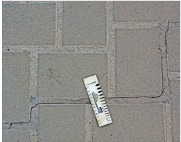
Abbildung 6: Rissbildung in einer vollgebundenen Pflasterdecke.
