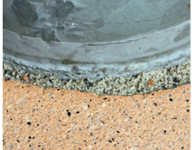
Abbildung 8: Fehlende Bewegungsfuge im Bereich eines aufgehenden Bauteils.
