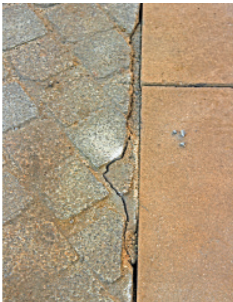
Abbildung 11: Ausbrüche an den Randsteinen der gebundenen Pflasterdecke.
