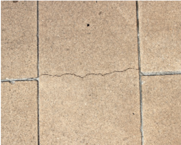
Abbildung 4: Gerissene Betonplatten in einer gebundenen Pflasterdecke.
