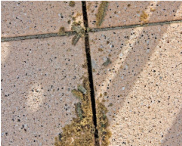
Abbildung 9: Zerstörung des Fugenmörtels.
